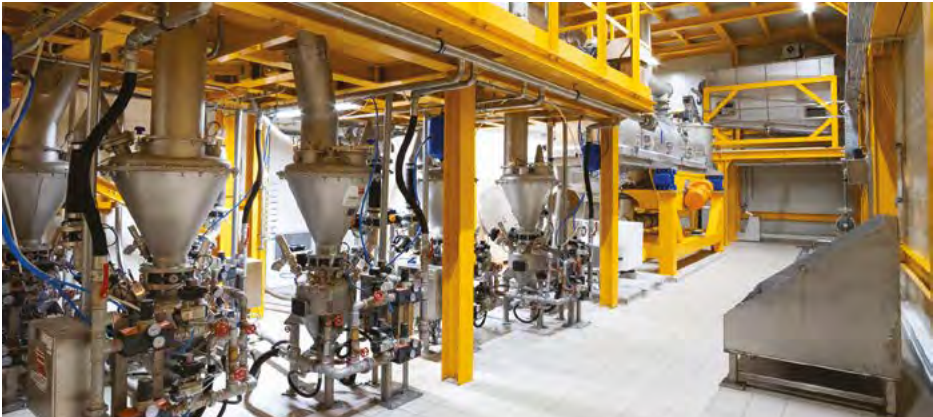
Un dettaglio del nuovo impianto per la produzione di acido tartarico di Caviro Extra
