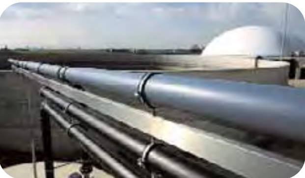
Un altro esempio di intervento della BCC ravennate e imolese sul territorio: la centrale di energia elettrica a biomasse di Medicina (Bo).
