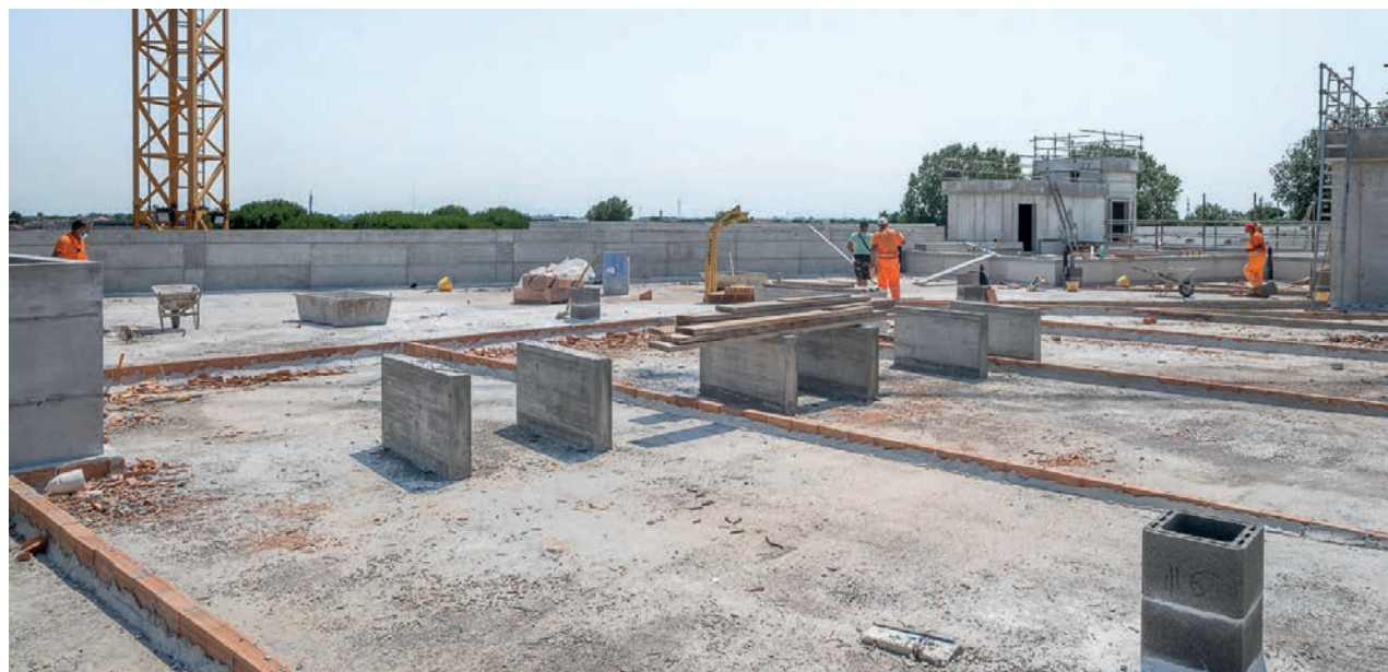
Operatori della Cmcf al lavoro nel cantiere della Rosa dei Venti a Borgo Montone (Ra), in uno scatto di qualche mese fa
