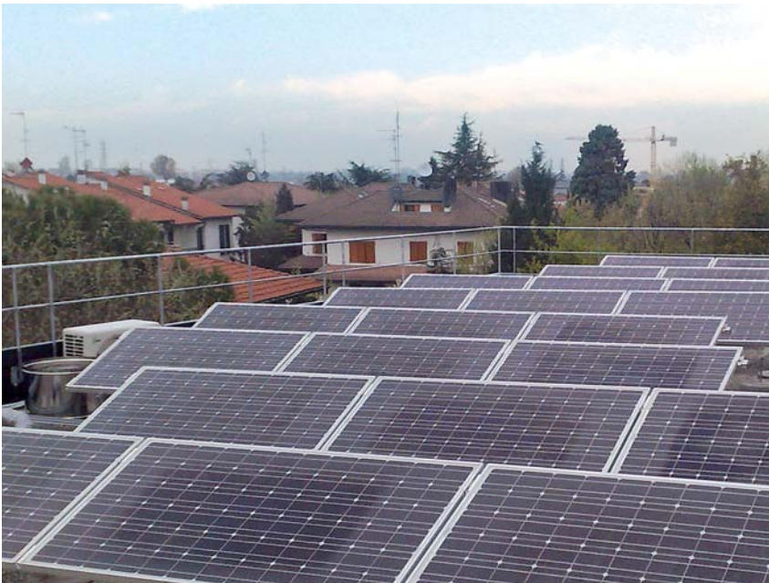
Il tetto fotovoltaico della Filiale BCC di via Laghi a Faenza: 180 mq in grado di sviluppare una potenza complessiva di picco pari a 9,5 kW.
