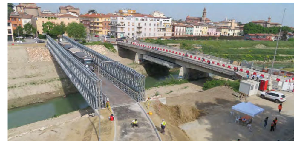
Faenza. L'antico ponte delle Grazie danneggiato dall'alluvione e in attesa di essere ricostruito. Accanto, il nuovo ponte Bailey che collega il quartiere Borgo Durbecco al centro città (foto Antonio Veca)
