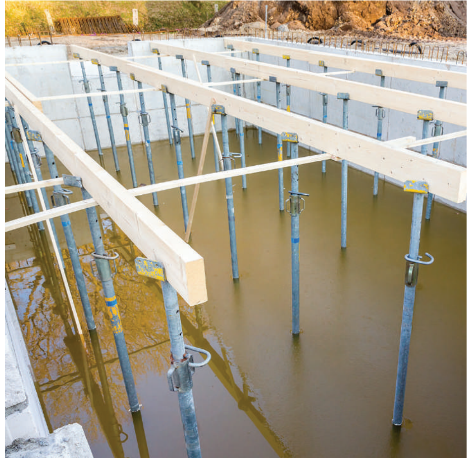
Fortunatamente sono stati pochi i cantieri allagati e il ripristino è avvenuto in tempi rapidi (foto di archivio)
