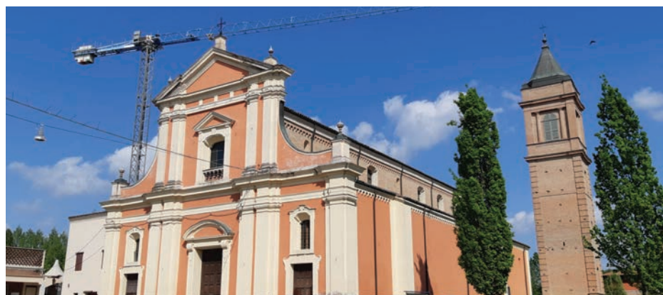
Nonantola, riparazione e rafforzamento locale della Pieve di San Michele Arcangelo. Cantiere in corso
